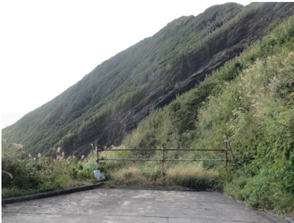
大千代港に通ずる道路の崩落現場
